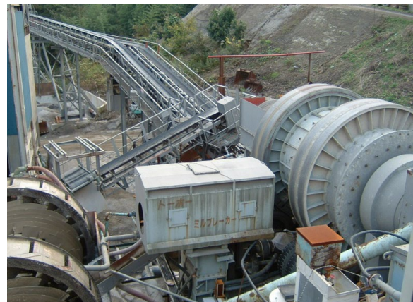
再生骨材の製造設備
