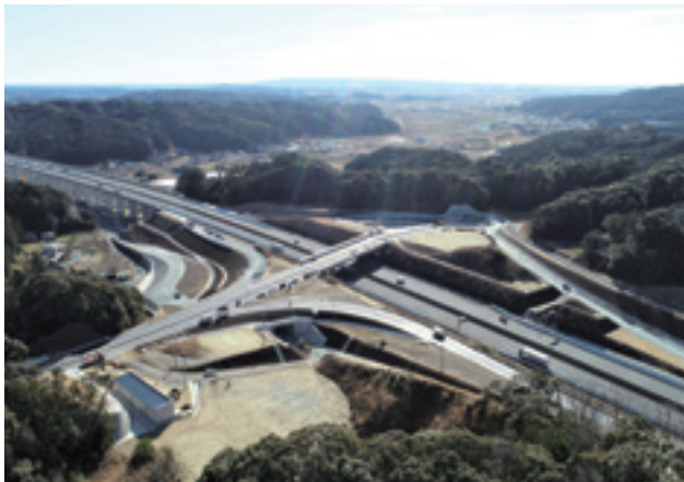
新東名高速道路 新磐田スマートインターチェンジ工事 静岡県磐田市
