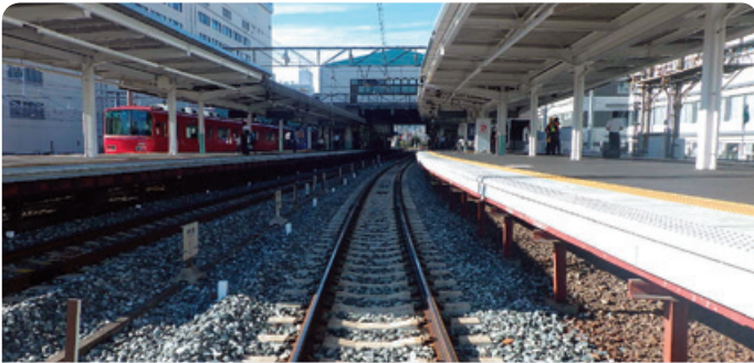
名古屋本線・常滑線 神宮前駅改良 施工場所: 愛知県名古屋市熱田区 名古屋本線・常滑線 神宮前駅構内PCマクラギ化 発注者: 名古屋鉄道株式会社
