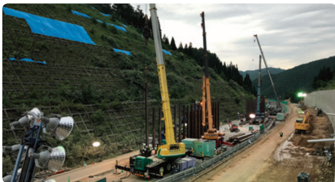
▲平成30年7月豪雨時の東海北陸自動車道の法面復旧工事状況①
