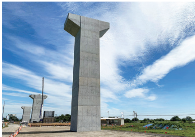
令和元年度 東海環状志津第1高架橋P14橋脚工事 岐阜県海津市
